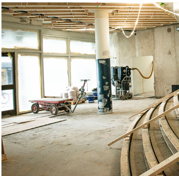
Renovering av Stadshallen med bland annat restaurering av puts och hållbara materialval samt bevarande av olika interiörer.
