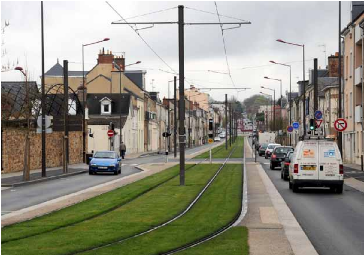
Figur 3-21. Kontaktledningsanläggning med enkel luftledning i franska Le Mans.
